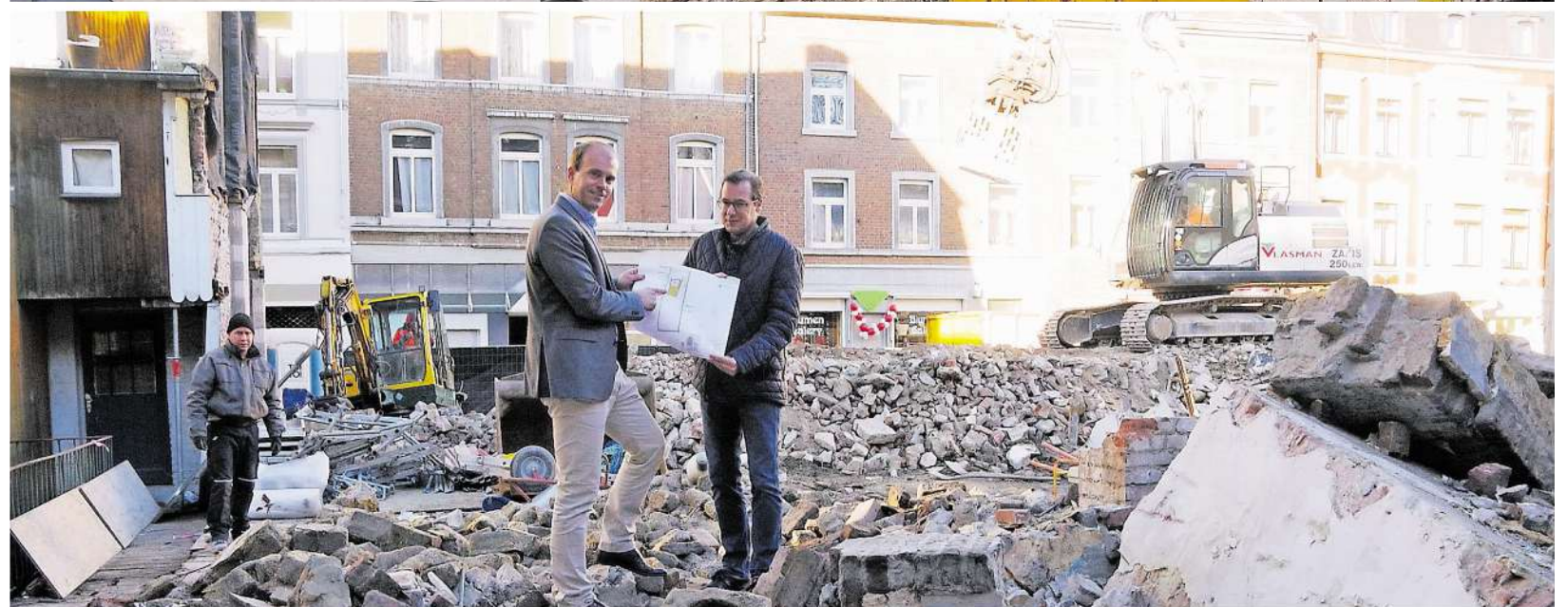
Die Burg aus ungewöhnlicher Perspektive. Der Abriss gibt den Blick frei auf das Wahrzeichen und wirft neues Licht auf den Steinweg.
