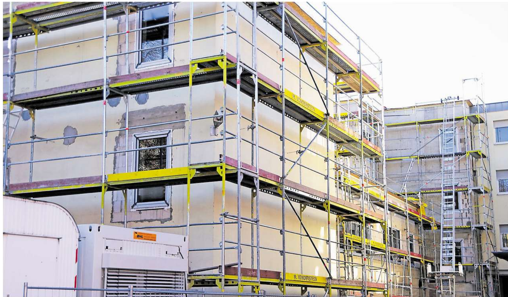
Am Gesundheitszentrum geht es voran: Vom Vichtbach aus erkennt man gut, dass der Neubau den alten Fundamenten folgt.
