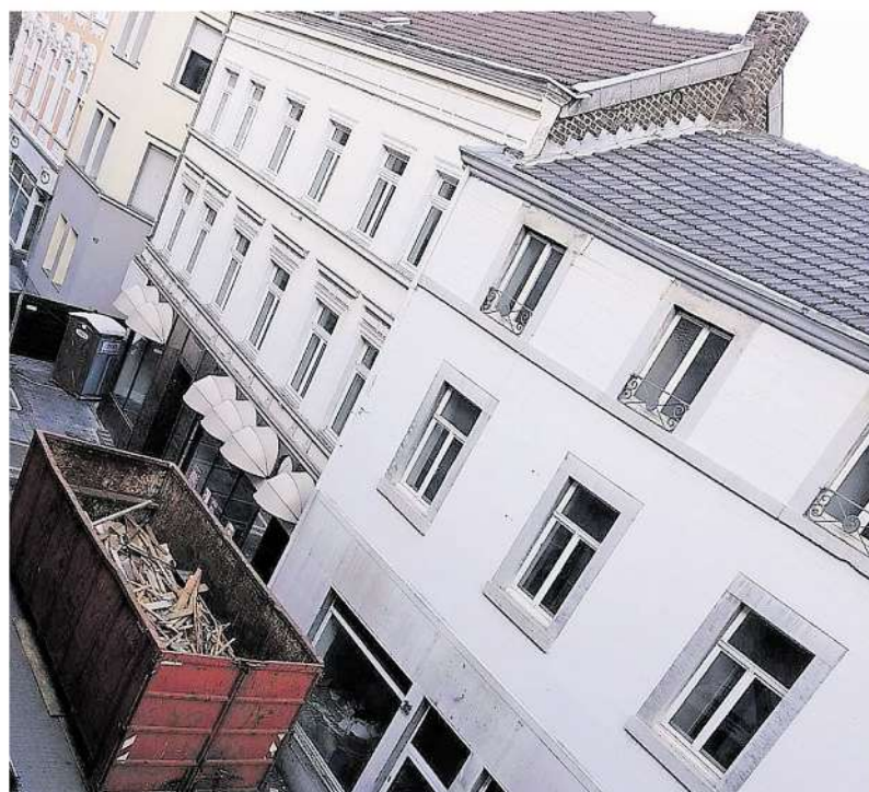
Ein neuer Quartiersplatz soll im Steinweg entstehen. Die Arbeiten dafür haben bereits begonnen.
