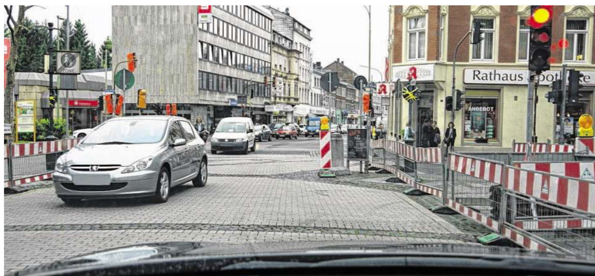
Der Umbau der Rathausstraße verzögert sich um 13 Wochen: Die Stadt hat der beauftragten Firma gekündigt. Lube & Krings beginnt nun nach Vorbereitungen und Ferien am 14. August. Foto: J. Lange
