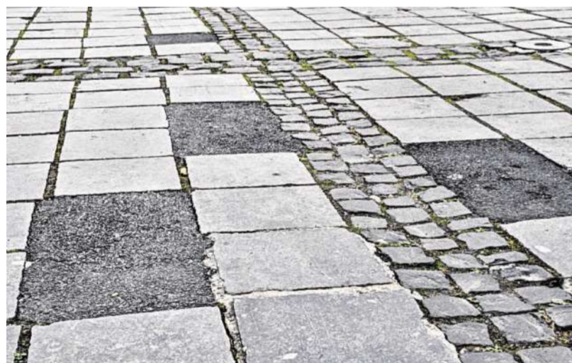
Rückkehr des Blausteinpflasters: Der Flickenteppich aus Asphalt auf dem Kaiserplatz soll im Frühjahr 2018 Geschichte sein.
