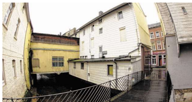
Neben den beiden Häusern am Steinweg (r.) soll die Bachüberbauung und das gelbe Werkstattgebäude (l.) abgerissen werden. Foto: J. Lange
