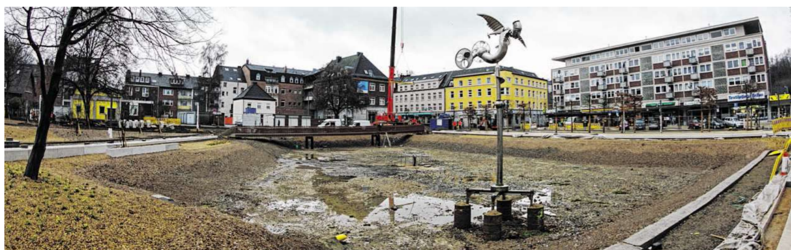
Das zukünftige Erscheinungsbild des Bastinsweihers (unten) wird langsam erlebbar, nachdem die Brücke gestern geliefert und aus drei Teilen montiert wurde. Die präzisen Arbeiten verliefen reibungslos. Fotos: J. Lange
