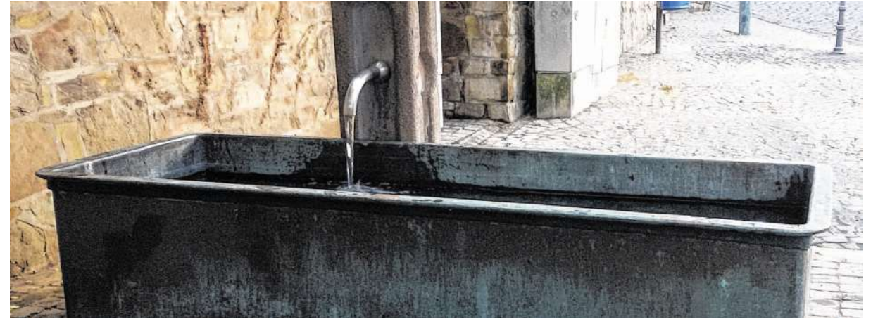
Mehr als zehn Jahre lang war die Anlage defekt. Jetzt funktioniert der Brunnen an der Burgstraße wieder.
