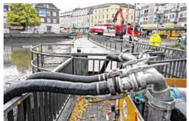
► Technisches Betriebsamt und Feuerwehr pumpen das Wasser aus dem Weiher in den Mühlgräben zum Vichtbach.
