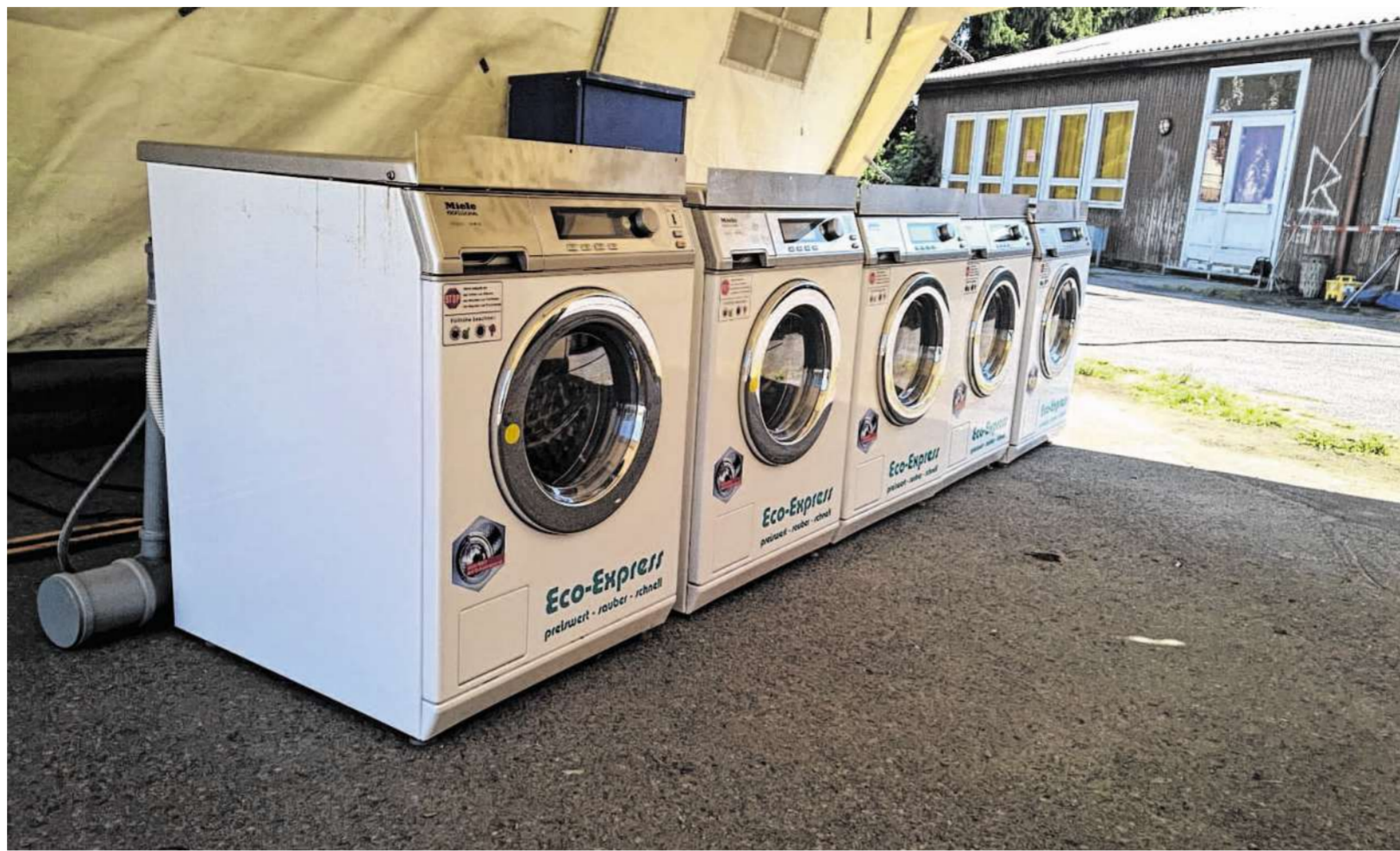
Die fleißigen Mitarbeiter des Technischen Hilfswerkes haben sich zuletzt bei der Einrichtung zahlreicher Flüchtlingsunterkünfte in der Region mit eingebracht und auch für den Anschluss von Waschmaschinen in Stolberg gesorgt.
